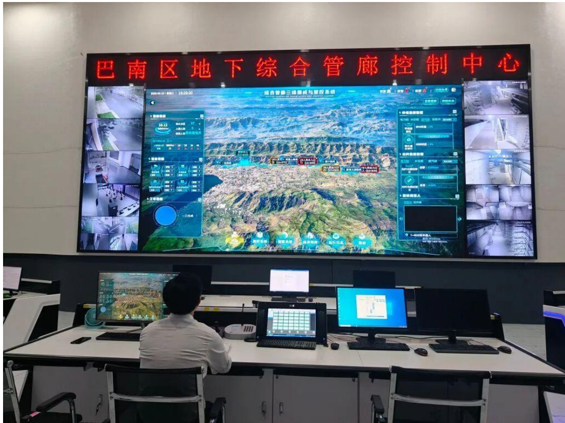
2026年6月16日，在重庆市巴南区地下综合管廊控制中心，工作人员通过综合管廊三维集成与管控系统查看巴南区龙洲湾片区地下综合管廊的环境、结构等监测数据。新华社记者郑世昌 摄
